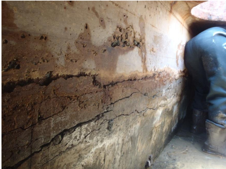
9) Sta 128 Left Side Longitudinal Cold Joints
