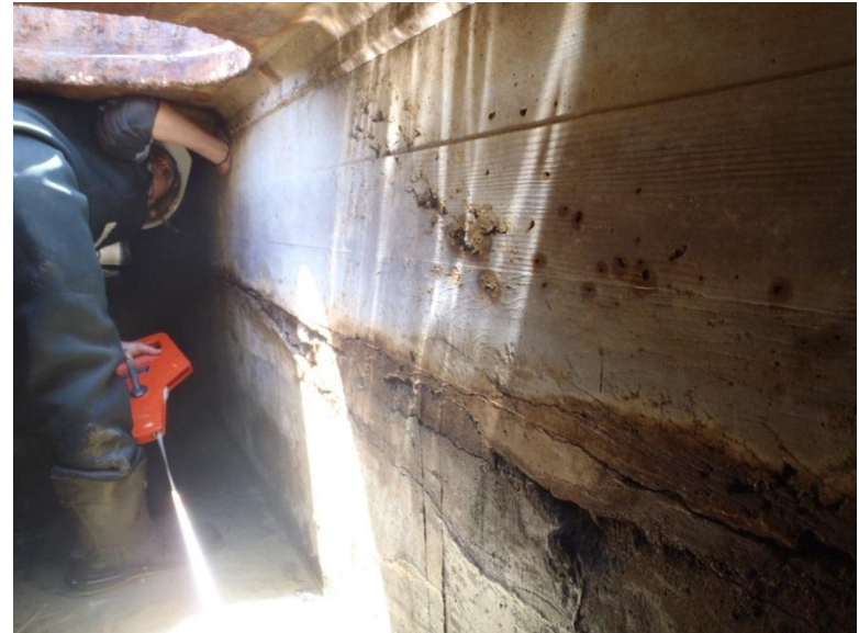
10) Sta 128 Right Side Longitudinal Cold Joint/Crack
