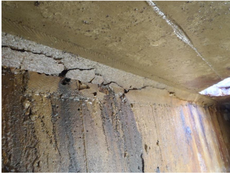
5) Sta 10 Right Side Top Long Crack
