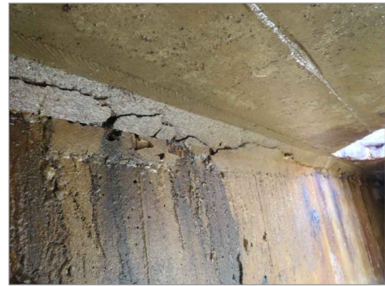
STA 0+10 LEFT SIDE TOP LONG CRACK
