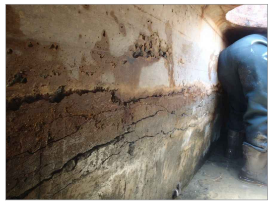
STA 1+28 LEFT SIDE LONGITUDINAL COLD JOINTS
