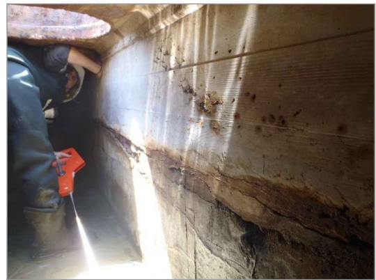
STA 1+28 RIGHT SIDE LONGITUDINAL COLD JOINTS
